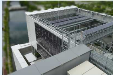
太陽光パネル
